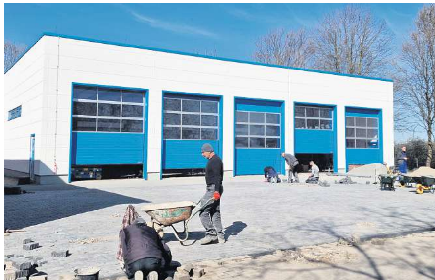
Die Arbeiten rund um die neue Fahrzeughalle auf dem Gelände der FTZ in Groß Düngen sind so gut wie abgeschlossen. Die 370 Quadratmeter große Halle bietet Platz für fünf Fahrzeuge. Die Fertigstellung ist für Ende April geplant.
