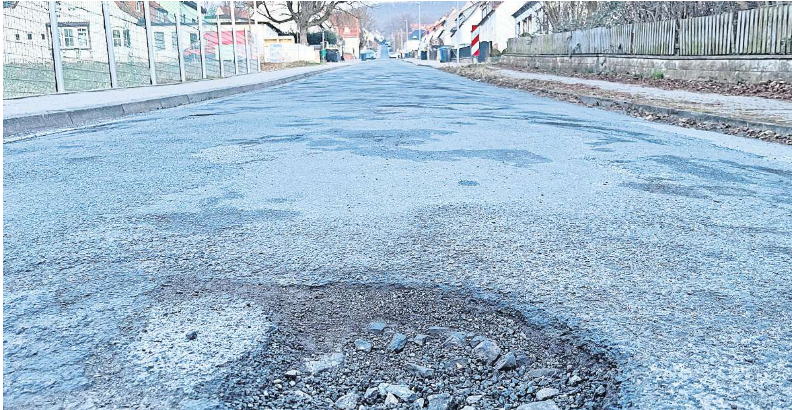
Die Göttingstraße in Bad Salzdetfurth ist eine von zwei Straßen im Stadtgebiet, für deren Sanierung schon Haushaltsmittel veranschlagt sind. Allerdings verzögert sich der Start, weil bei der ersten Ausschreibung von keiner Firma ein wirtschaftliches Angebot einging.
